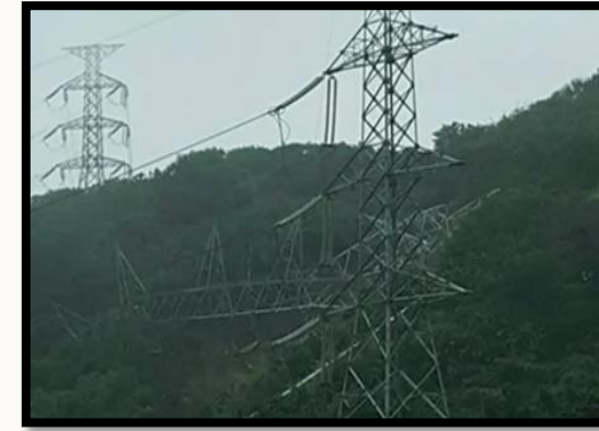
2號機輸電鐵塔倒塌
