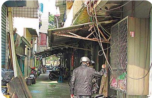
Foto 5 Las casas del área Xin Cao Ya dificultan los sistemas contra incendios
