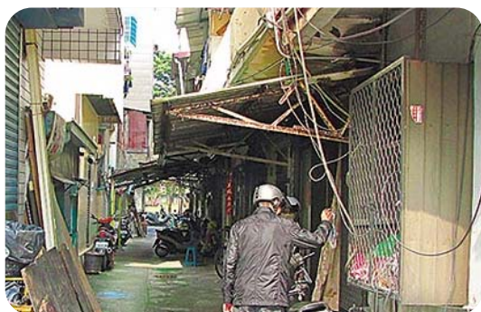
圖 5 新草街建築路包厝、厝包路，影響消防救災
