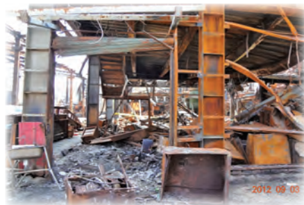
◆ 氣爆工廠滿目瘡痍之廠房
