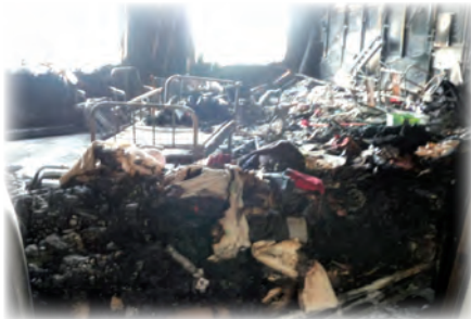
◆ 北門分院大火災後現場
