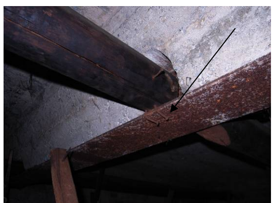
【照片 3-1-11】原木樑上釘鐵釘反勾工字形鋼樑
