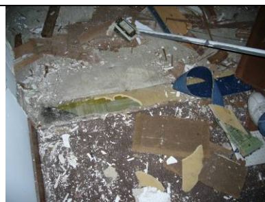
【照片 3-2-17】因過去使用 PVC 地磚為地坪材料，在去除地磚後，原有殘膠仍難以去除。
