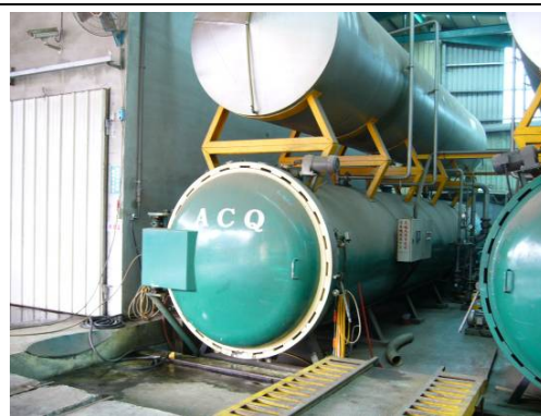
【照片 5-3-2】真空加壓槽 970108
