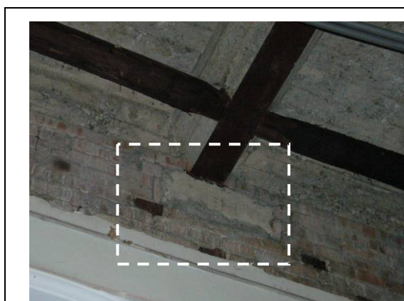
【照片 3-1-1】混凝土塊
