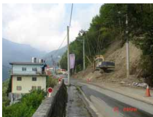
照片 D8 上巴陵風景特定區內道路邊坡危險建築與上邊坡崩塌情形
