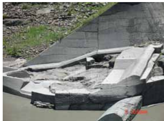
照片 A1-4 義興壩壩體毀損
