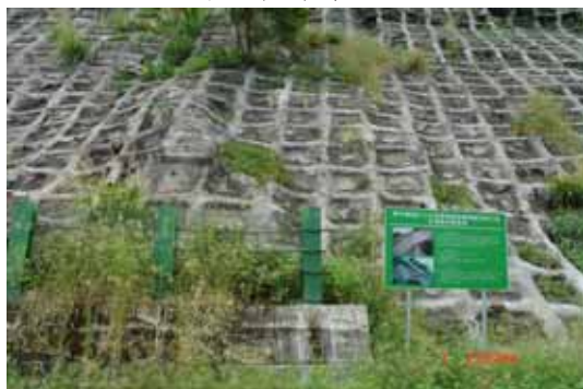
照片 B5 泰平隧道口附近道路上邊坡崩塌，進行植生穩固工程
