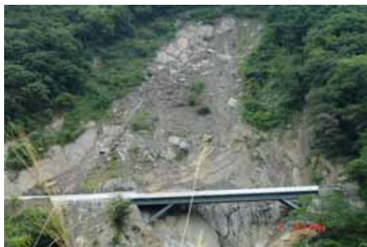
照片 B4-2 道路邊坡地質脆弱，大量崩塌裸露
