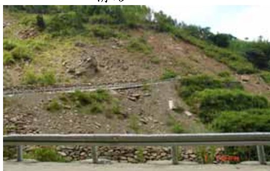
照片 B10-3 道路上、下邊坡崩塌情形
