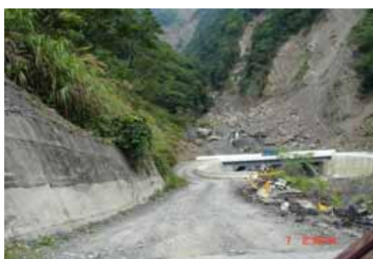
照片 B3-5 道路上、下邊坡崩塌情形
