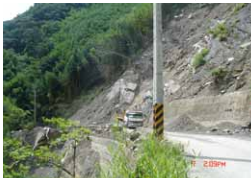
照片 B8 竹 60-1 線道路邊坡崩塌，土石鬆動下移
