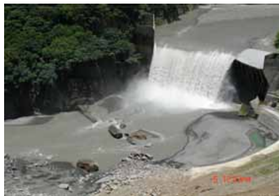
照片 A3-2 毀損及固岸情形
