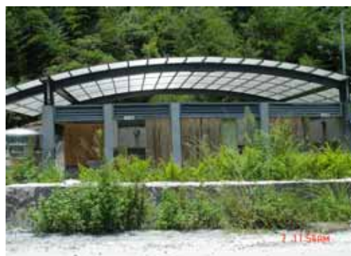
照片 D24 玉峰溪附近坡面崩塌嚴重，人車罕至，道路邊坡蓋有美崙美奐公廁
