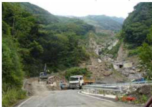
照片 B6 地質條件不良加上溪流沖刷，造成下游河岸兩旁及道路崩塌情形
