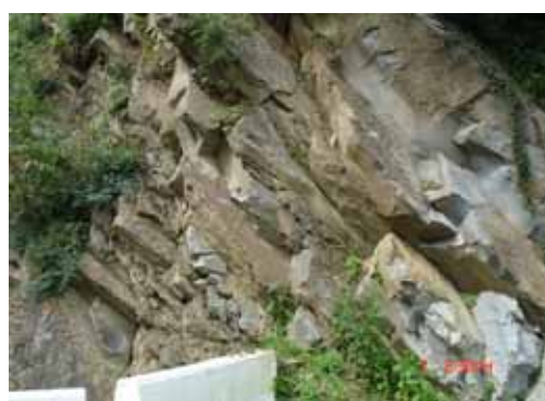
照片 B4-1 道路邊坡地層破碎，節理發達
