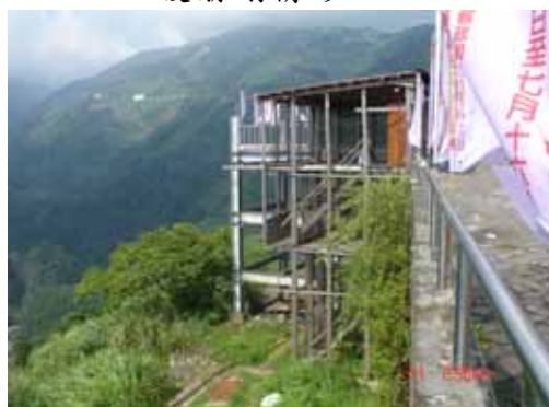
照片 D10 上巴陵公有免費停車場下方邊坡即有超限利用種植水蜜桃及違建情形
