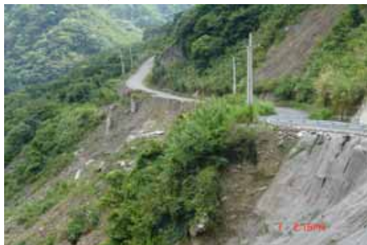
照片 B7 竹 60-1 線多處道路上下邊坡崩塌情形
