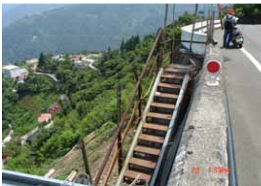
照片 C2-1 往上巴陵農路 6.5 公里處下方邊坡限利用
