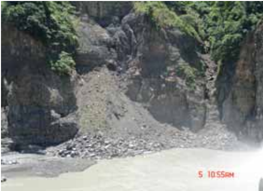
照片 A1-7 義興壩上游邊坡崩塌
