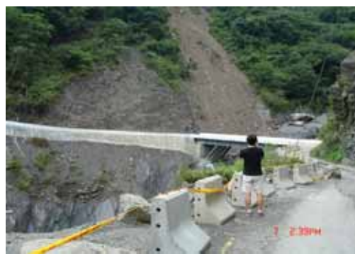
照片 B3-4 道路掏空，橋樑損毀
