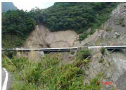
照片 B4-3 大量崩塌造成道路損毀，現場已完成修建
