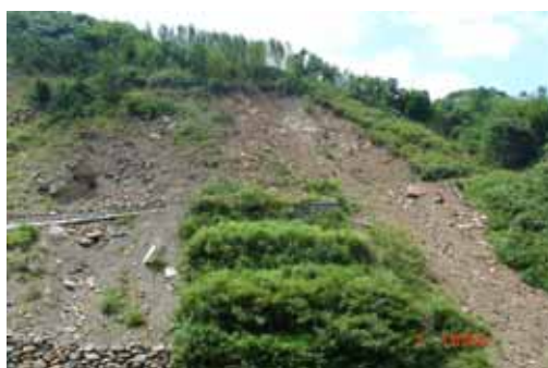
照片 B10-4 道路上、下邊坡崩塌情形
