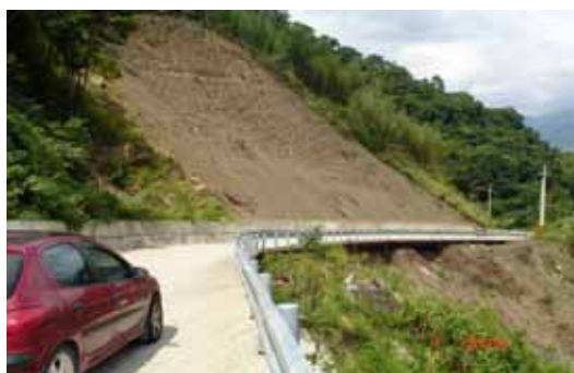
照片 B10-1 田埔附近道路邊坡崩塌情形
