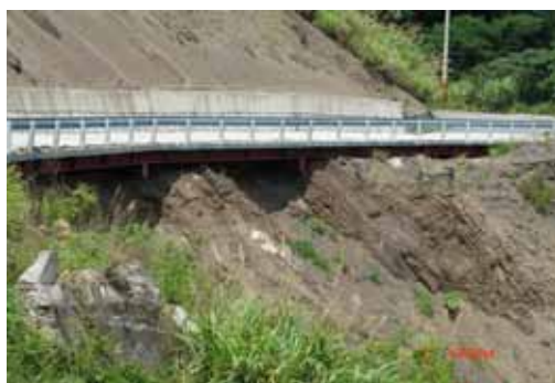
照片 B10-2 道路邊坡崩塌
