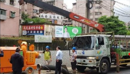
十河局機動支援抽水機
