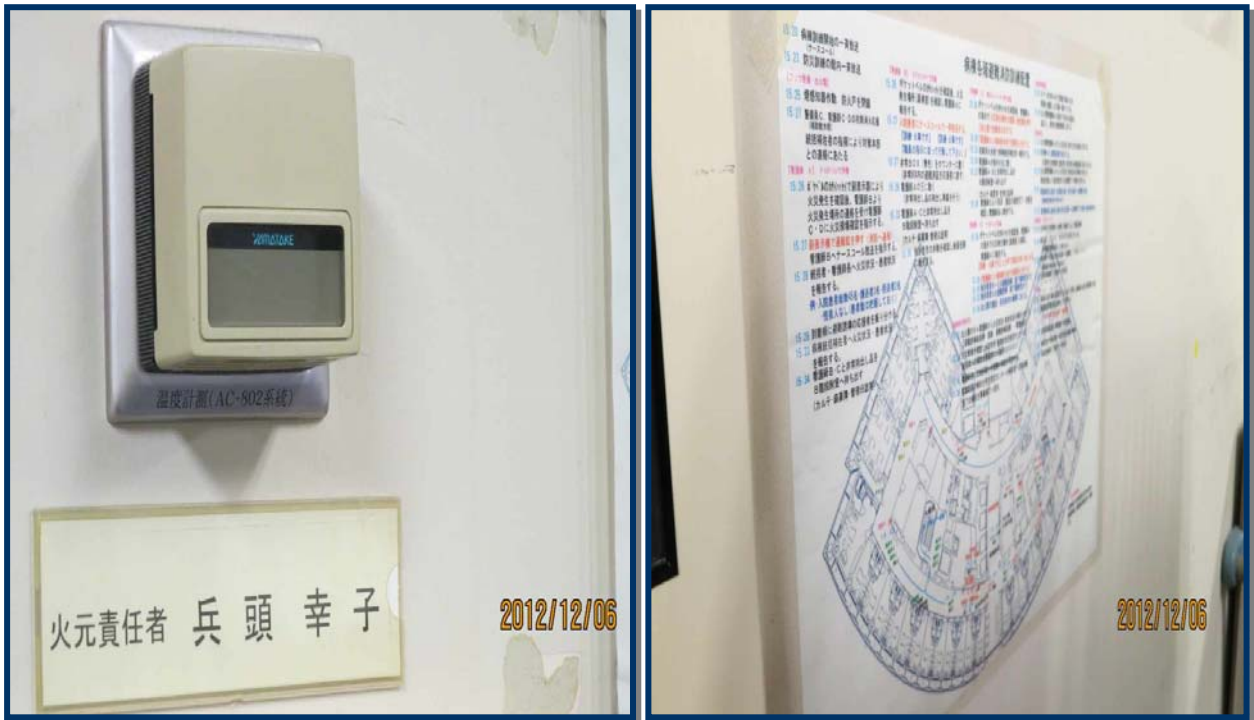
照片 8-4、住友病院病房相關消防通報、負責人及相關設施設置情形
