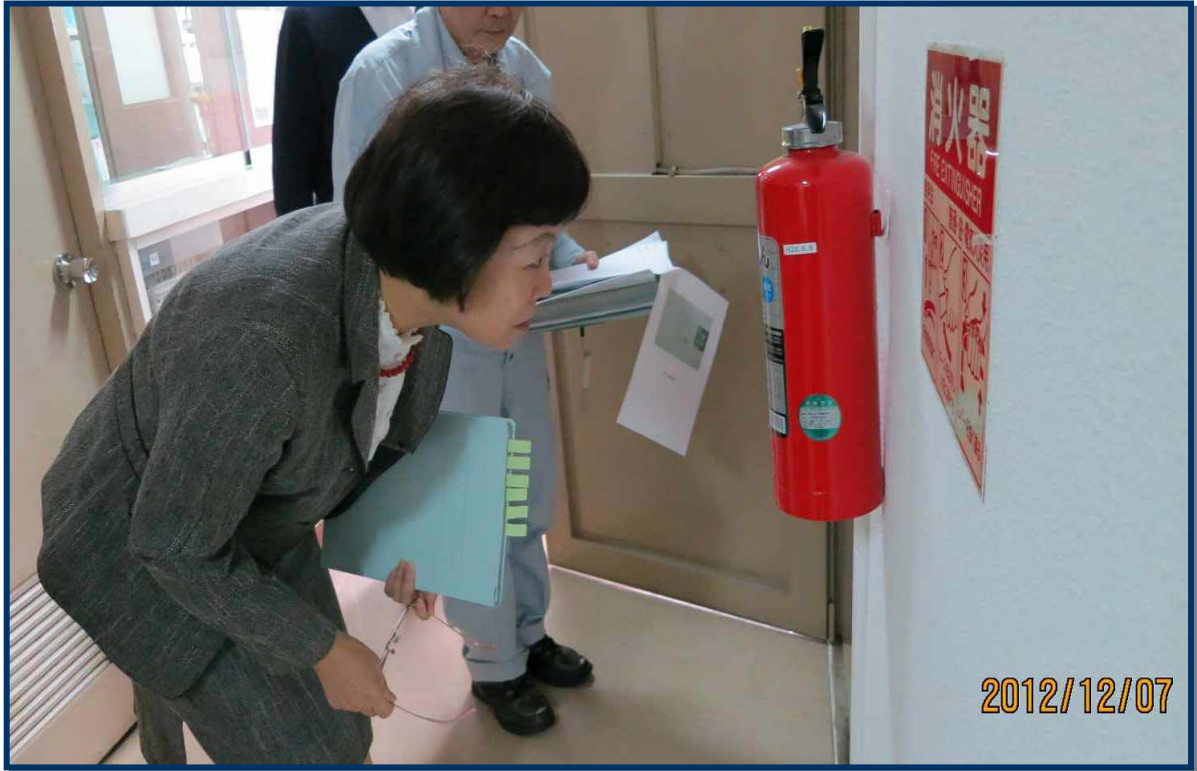
照片 11-3、本院尹委員實地參訪大鵬會千本醫院消防設備
