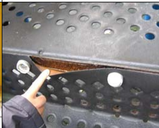
照片 2-1-11 綜合遊具平臺階梯面層剝離，內部積水、鏽蝕
