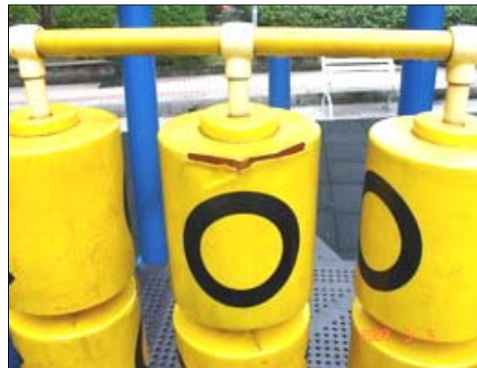
照片1-4-7 綜合遊具平臺護欄元件破損
