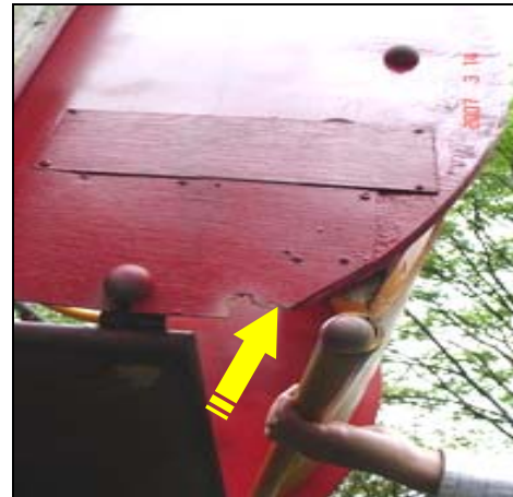
照片 1-9-3 綜合遊具平臺護欄固定螺栓孔破裂
