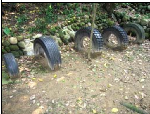
照片 2-5-3 山區下方輪胎組無安全地墊
