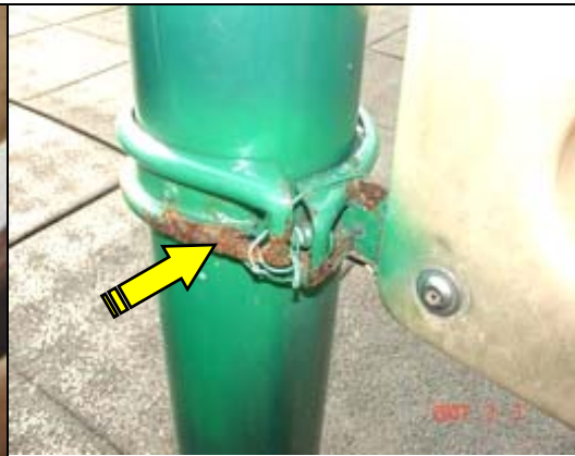
照片1-7-5 綜合遊具平臺護欄連接點鏽蝕
