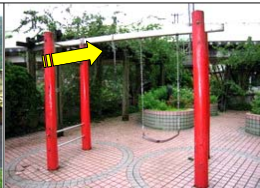
照片 2-17-2 鞦韆損壞未拆除亦未警示
