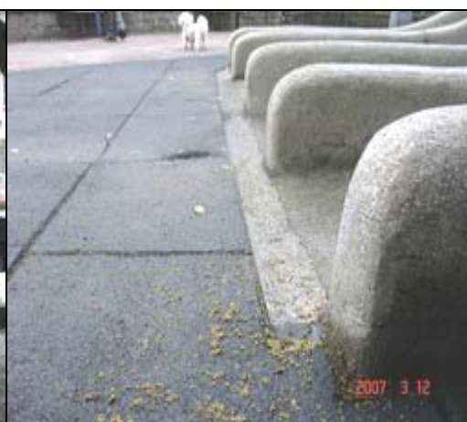
照片1-5-8 滑梯滑槽底端與地面無高差
