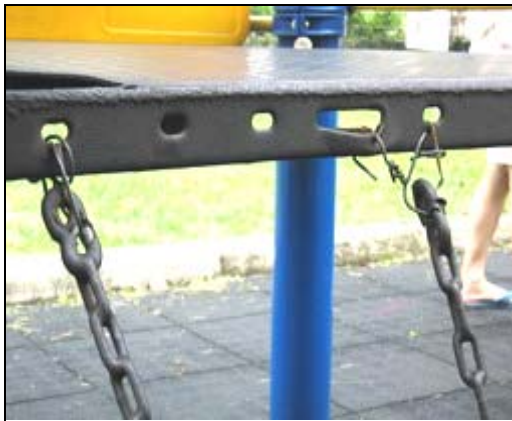
照片 3-4-6 綜合遊具攀爬鐵鍊斷裂，竟僅用鐵絲網綁
