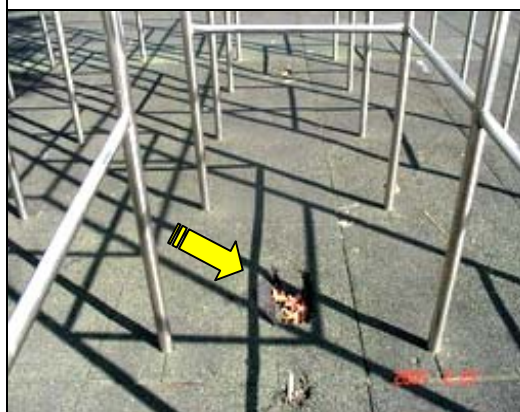
照片 1-1-3 攀爬架下安全地墊破損
