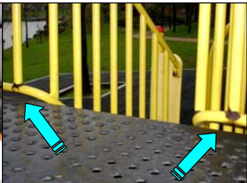
照片3-12-4 綜合遊具欄杆鏽蝕
