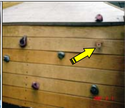
照片 1-3-3 攀岩組元件脫落
