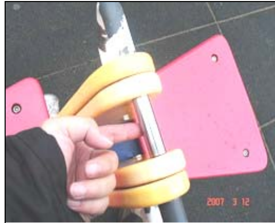
照片 1-5-5 翹翹板扶手鬆脫、晃動
