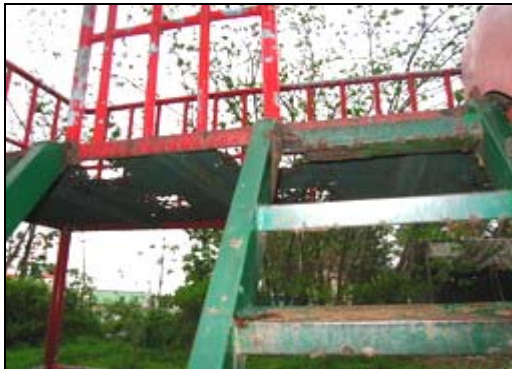
照片 4-2-9 滑梯爬階鏽蝕、平臺板鏽蝕破洞
