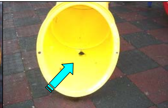
照片 3-11-2 綜合遊具之滑槽底端破損
