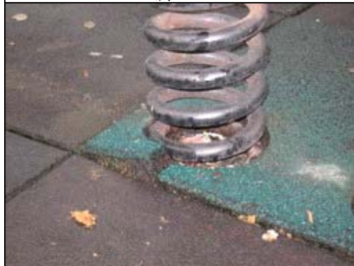
照片 2-7-6 翹翹板基座螺絲鬆弛，安全地墊隆起
