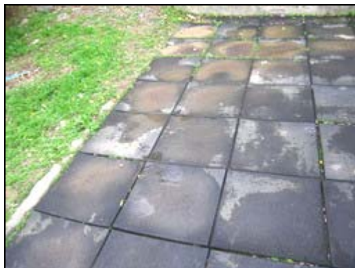
照片 4-2-1 安全地墊縫積水、泥沙且部分變形
