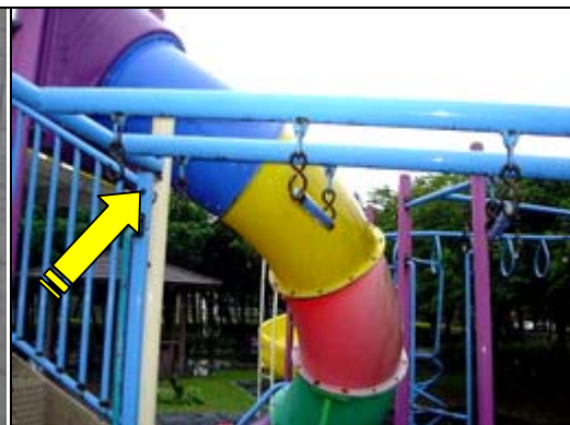
照片 3-10-2 綜合遊具之吊桿脫落
