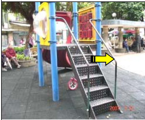
照片 1-2-7 綜合遊具之階梯扶手鬆動
