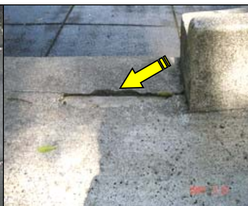
照片 1-11-4 滑梯滑槽底端水泥表面剝落
