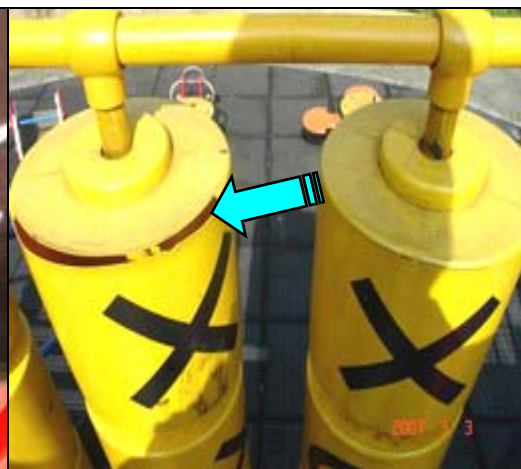
照片 1-7-7 綜合遊具平臺護欄元件破損
