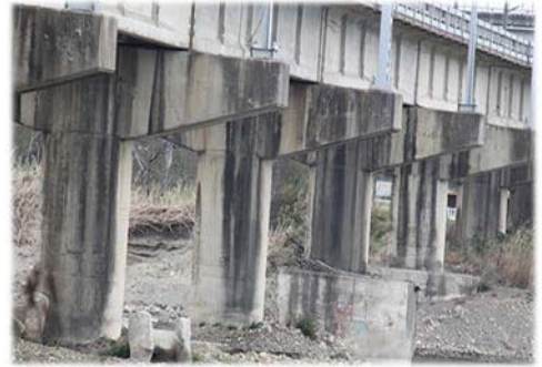
監察委員履勘重要橋梁發現橋基遭洪流冲刷嚴重
