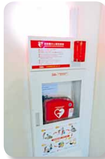
Un desfibrilador automático externo fue instalado al lado de la entrada del Centro para recepción de las quejas del pueblo a fin de asegurar las condiciones de salud de los demandantes y trabajadores.
