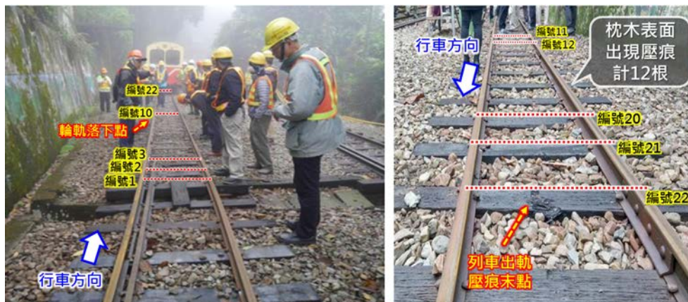
圖 9 第 11-22 根枕木表面有明顯列車出軌壓痕
