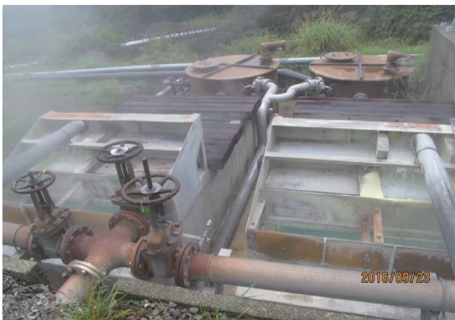
照片 29 箱根町營溫泉沉澱槽及集湯槽
