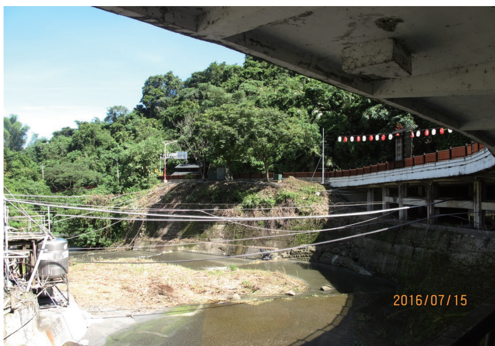
照片 9 本案調查委員履勘時行經溫泉加水站時發現溫泉管線拉設情形
