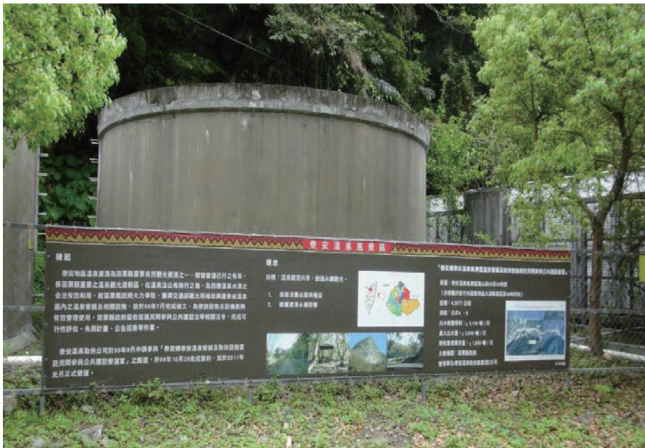
照片 4 本案調查委員履勘泰安溫泉取供事業（股）公司設備
