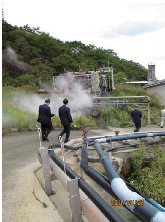
照片 33 箱根町營溫泉輸送管線排氣及防震設施
