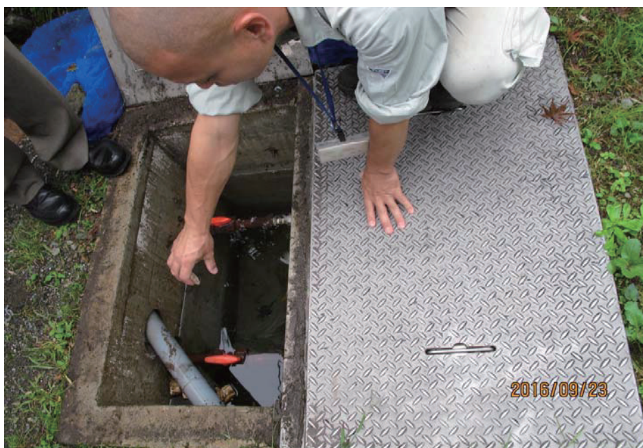
照片 35 箱根町營溫泉用戶計量設備
