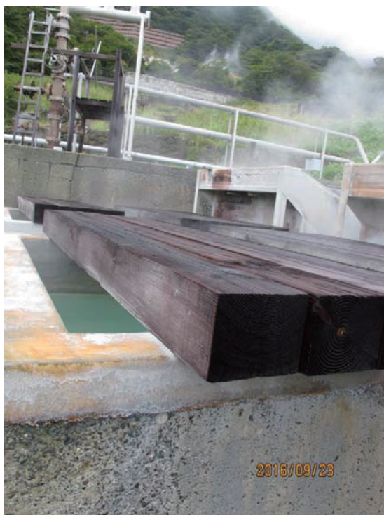
照片 34 箱根町營溫泉沈澱槽內設量水堰
