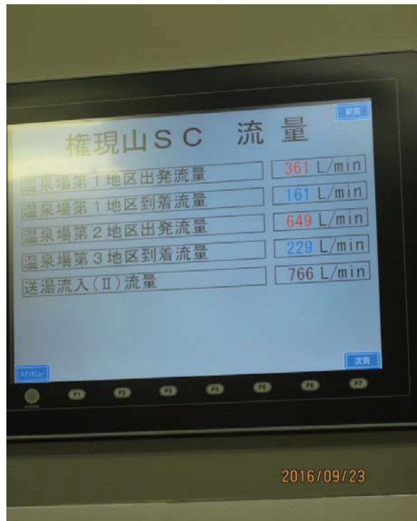
照片 47 湯河原町營溫泉控制室之監控面板畫面
