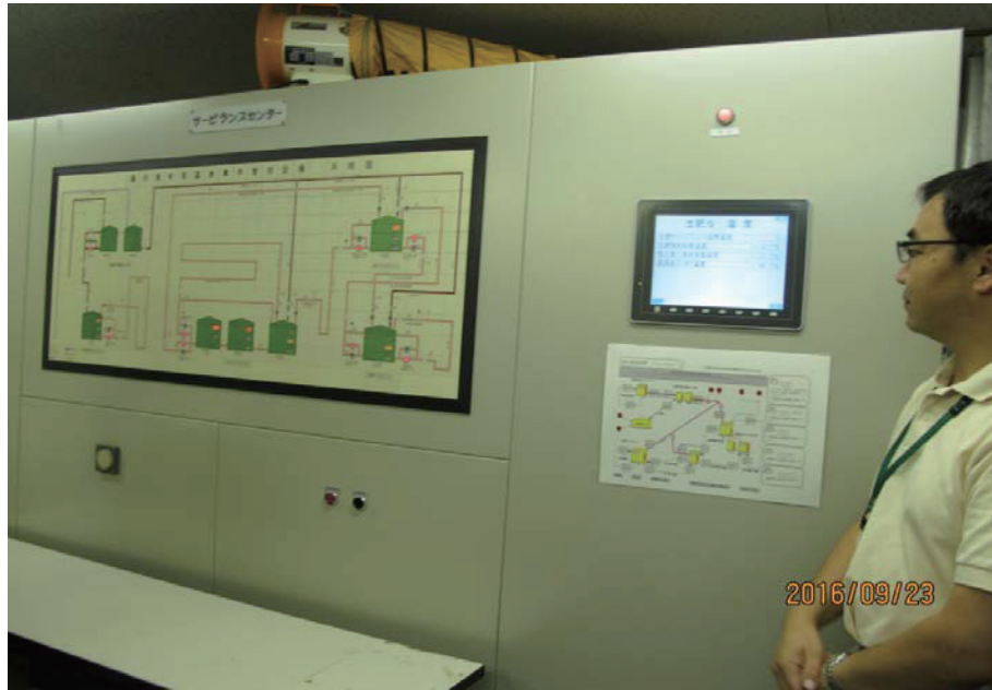
照片 46 湯河原町營溫泉控制室之監控面板
