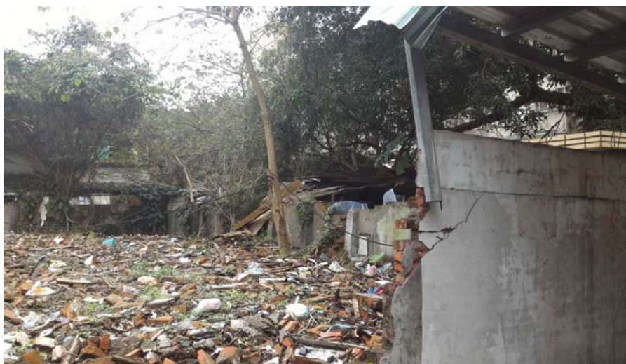
碧潭吊橋東岸主纜錨座位處私有土地下雜草叢生
