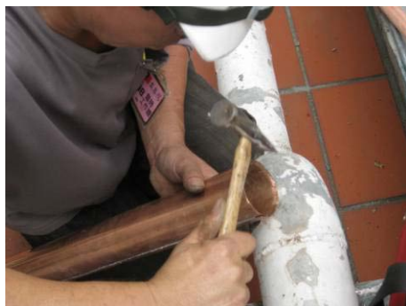
【照片 5-6-275】敲擊落水管至往外擴散約 0.5 公分(98.12.25)
