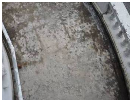
【照片 3-1-180】平台裂縫細部(98.12.20)
