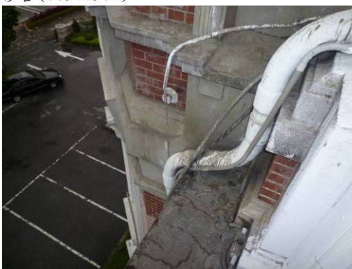
【照片 3-2-45】中央穹頂避雷針導線以絕緣 體固定於結構體上(98. 12. 31)
