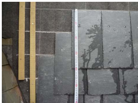
【照片 5-5-42】石板瓦外露 16 公分， 1、3 層石板瓦搭接 9 公分(98.09.28)
