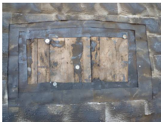
【照片 3-1-146】防水層 4 層：第 1 層油毛氈碎片 (98.11.05)
