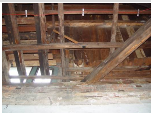
【照片 3-2-23】西翼 201 室塔樓屋頂老虎窗水漬(98.07.01)
