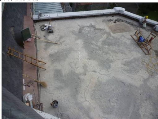
【照片 3-1-173】M 形樓梯平台 RC 樓板裂縫 (98. 11. 30)
