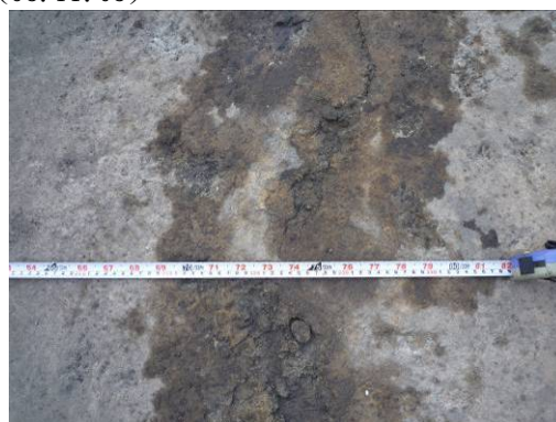
【照片 3-1-158】裂縫細部 (98. 11. 05)
