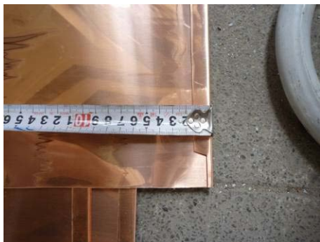
【相片 5-6-91】梯形收邊切口細部 (98.08.26)
