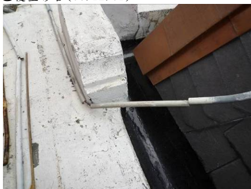
【照片 3-2-60】北翼塔樓導線包覆塑膠管因 年舊破損(98. 12. 31)
