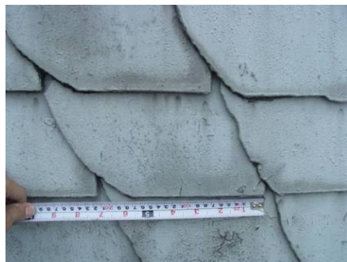
【照片 3-1-98】中央穹頂 1 區之石綿瓦下寬為 17 公分(98.06.02)
