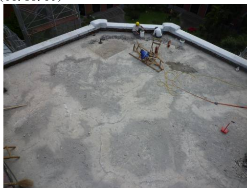
【照片 3-1-174】M 形樓梯平台 RC 樓板裂縫 (98. 11. 30)
