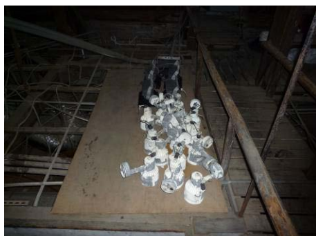
【照片 5-2-9】照明燈具集中存放於貓道兩側(98.08.01)
