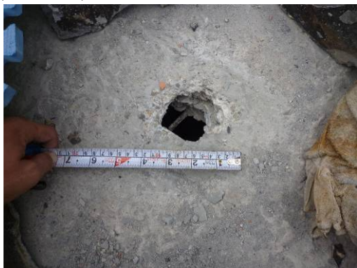
【照片 3-1-177】M 形樓梯平台敲除所產生的 破洞約 10 公分(98. 12. 01)
