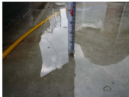
【照片 5-4-64】水深至平台最高處約 1.5 公分(98. 11. 30)
