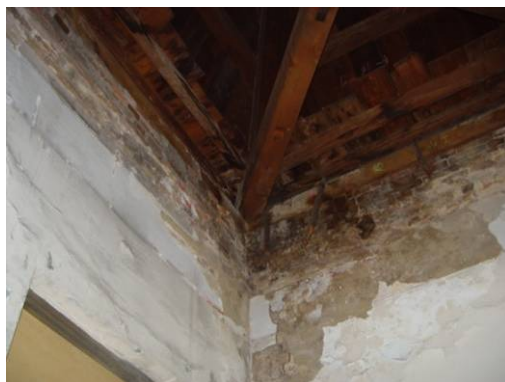
【照片 3-2-26】西翼屋頂轉折處水漬(98.07.01)
