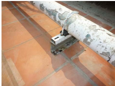
【照片 5-2-43】消防管線固定細部 (99.03.12)
