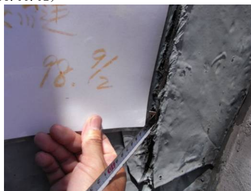
【照片 3-2-36】北翼 3 區老虎窗右側銅板裂縫 (98.09.02)
