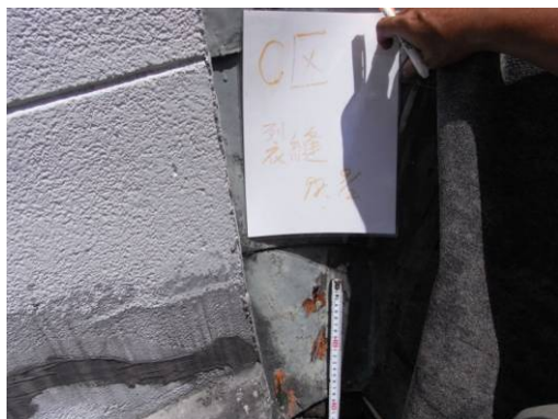
【照片 3-2-33】西翼 8 區老虎窗左側銅板裂縫 (98.09.02)
