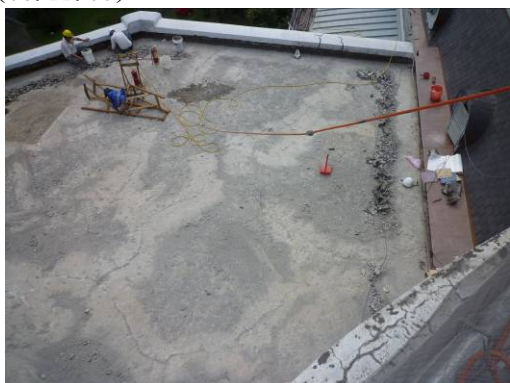
【照片 3-1-175】M 形樓梯平台 RC 樓板裂縫 (98. 11. 30)
