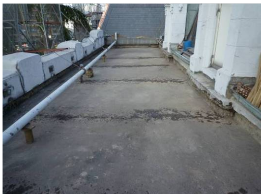
【照片 3-1-155】西翼 1. 2. 3. 4 區平台裂縫 (98. 11. 05)
