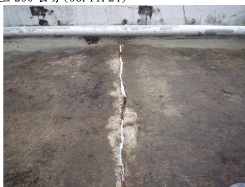
【照片 3-1-166】西翼 4 區平台分期施作之縫隙(98.11.24)
