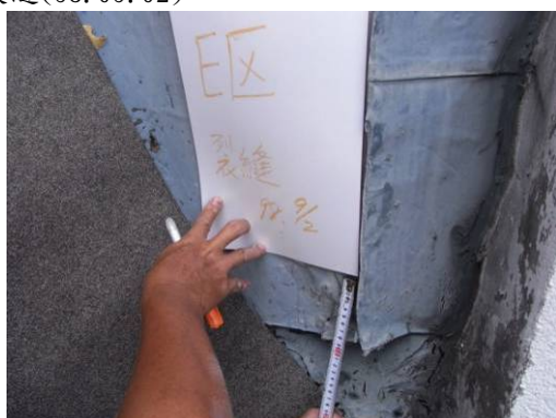
【照片 3-2-31】西翼 18、19 區老虎窗右側銅板裂縫(98.09.02)
