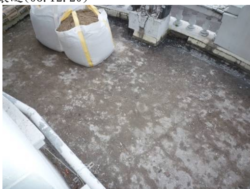
【照片 3-1-181】平台裂縫細部(98.12.20)
