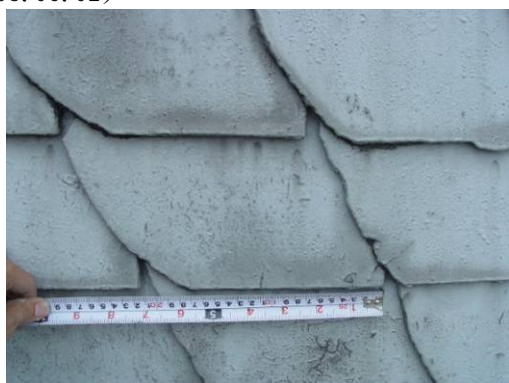
【照片 3-1-95】中央穹頂 8 區之石綿瓦下寬為 18 公分(98.06.02)
