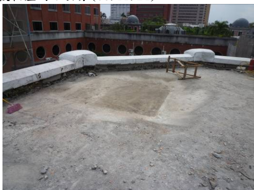
【照片 3-1-169】M 形樓梯平台填補過的位置，表面混凝土顏色較深(98.11.30)
