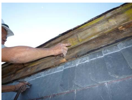
【照片 5-6-151】檢視塌陷位置(98.11.25)
