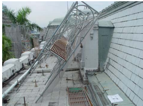
【照片 5-1-17】西翼鋼管鷹架受颱風影響倒塌(98.06.23)
