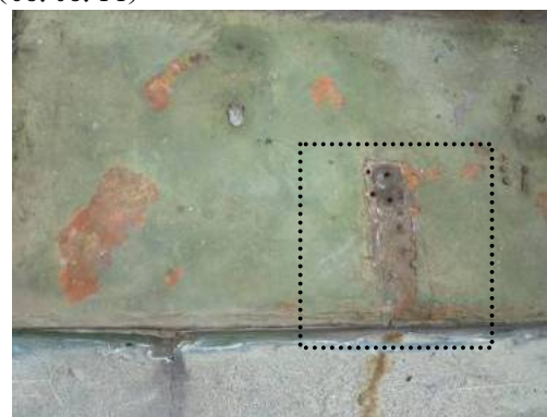
【照片 3-1-111】第 1 層原始銅製水切板表面之固定器痕跡(98.08.14)
