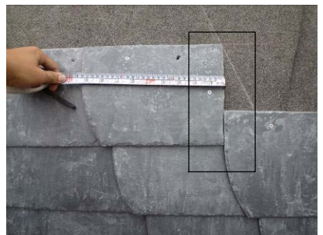
【照片 5-5-189】下緣石板瓦倒角約為 0.3-0.4 公分(98.11.29)
