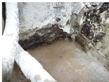
【照片 5-4-60】轉角處因泛水不足導致漏水(98. 12. 01)
