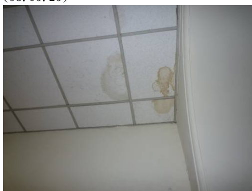
【照片 3-2-22】簡報室天花板水漬(98.10.09)
