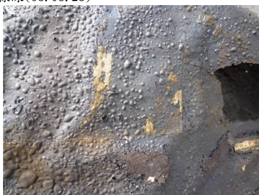
【照片 3-1-130】防水層 3 層:第 2 層油毛氈表面殘留之水泥纖維板碎片(98.08.28)
