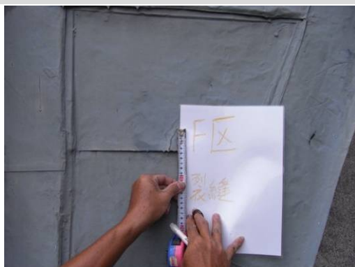
【照片 3-2-29】西翼 18、19 區老虎窗左側銅板裂縫(98.09.02)
