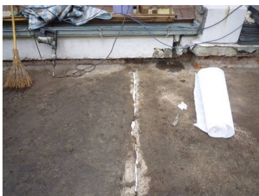
【照片 3-1-165】西翼 4 區平台分期施作之縫隙(98.11.24)
