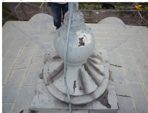
【照片 3-2-47】西翼塔樓前側避雷針基座有 砂利康修補痕跡(98. 12. 31)
