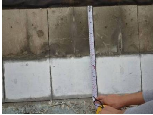
【照片 3-1-74】西翼 1 區屋面瓦長 43 公分 (98.08.03)
