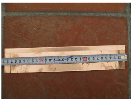
【照片 5-6-377】水切板下緣反摺 1.5 公分(98.12.26)
