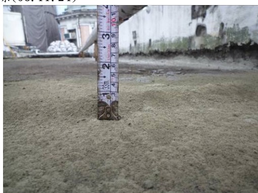
【照片 3-1-167】西翼 4 區平台分期施作之樓板相差約 3 公分(98.11.24)
