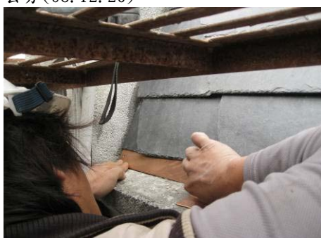
【照片 5-6-379】水切板由下往上延伸至屋面瓦內側約 3 公分(98.12.26)
