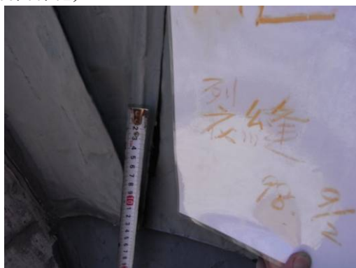
【照片 3-2-37】北翼 2 區老虎窗左側銅板裂縫 (98.09.02)
