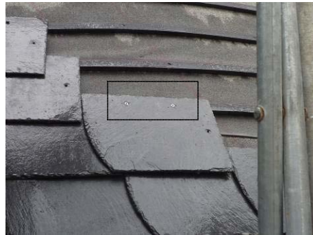
【照片 5-5-208】屋面瓦以螺絲釘固定 上緣兩孔(98. 12. 17)
