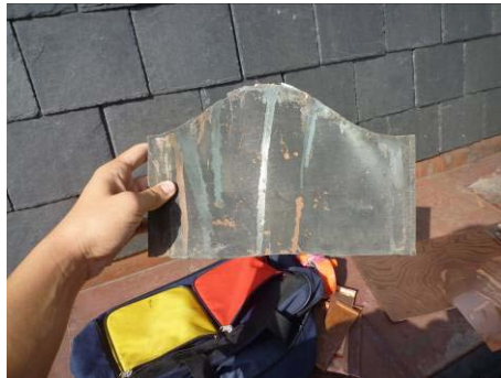
【照片 5-6-295】仿作損壞嚴重之構件 (98.12.15)
