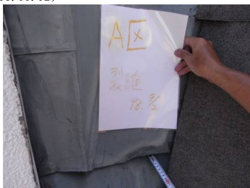
【照片 3-2-35】北翼 4 區老虎窗左側銅板裂縫 (98.09.02)
