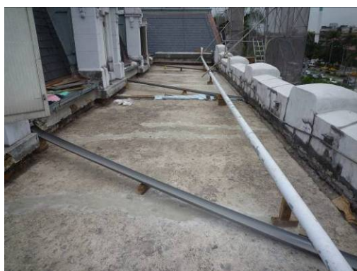
【照片 3-1-160】西翼 7. 8. 9. 10 區平台裂縫 (98. 11. 05)
