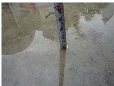
【照片 5-4-59】水深至平台最高處約 1 公分(98. 11. 30)
