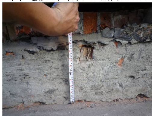
【照片 3-1-190】西翼 4 區平台(第二期興建)天溝內側木磚距離樓板約 20 公分(98.11.02)
