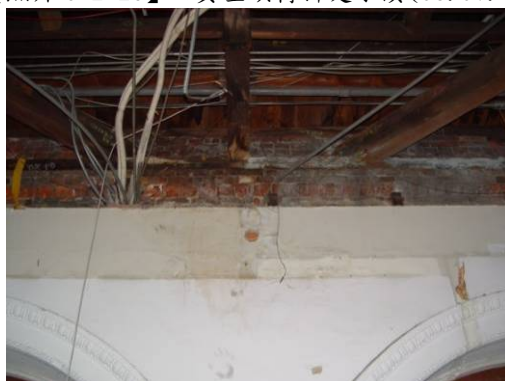
【照片 3-2-28】西翼 203 室牛眼窗周邊漏水(98.07.01)
