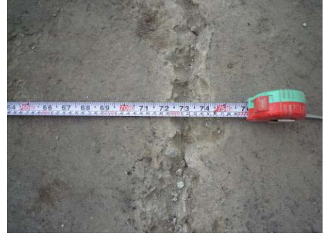
【相片 5-7-6】裂縫寬約 3 公分深約 2 公分(98.11.24)
