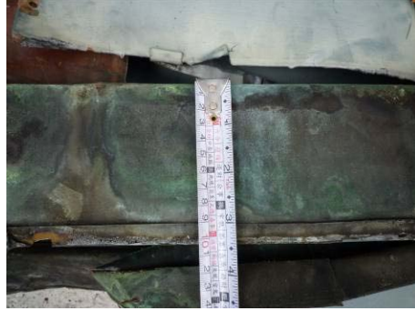
【照片 5-3-7】銅線板寬度 10 公分 (98.08.03)
