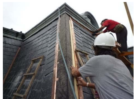
【照片 5-6-196】斜脊襯材高度不足，修補木料(98.10.22)
