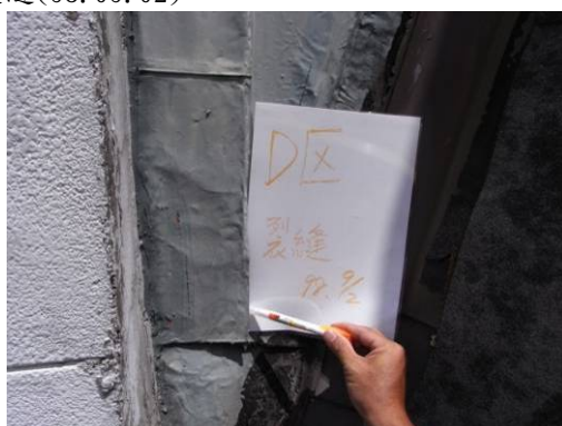
【照片 3-2-32】西翼 3 區老虎窗左側銅板裂縫(98.09.02)
