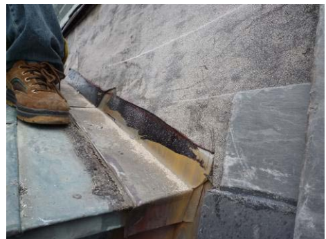
【照片 5-5-53】彈記銅板外露面積 6 公分(98.09.30)
