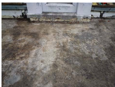
【相片 5-7-3】檢視裂縫位置(98.11.24)
