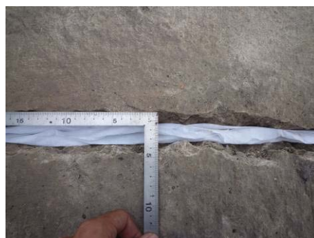
【相片 5-7-20】裂縫寬度約 5 公分(98.11.11)
