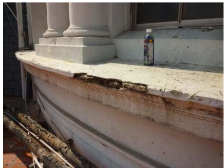
【相片 5-7-91】線角裝飾掉落缺損(99.03.12)
