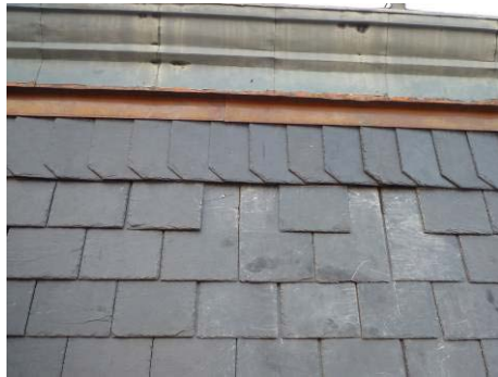
【照片 5-5-156】石板瓦破損相對位置 (98. 11. 25)
