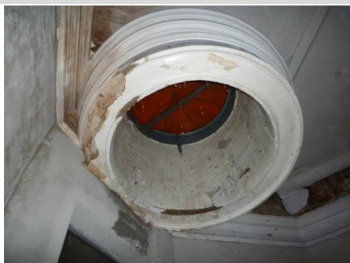
【照片 3-2-1】西翼 203 室八角形衛塔水漬(98.07.01)
