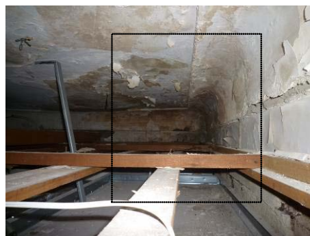
【照片 5-4-62】西翼 7、8、9、10 區平台試水期間展覽室漏水(98. 12. 01)
