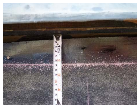
【照片 5-5-81】8. 頂層屋面瓦水平基準線(距離銅製簷板襯材約 9 公分處)(98.09.17)
