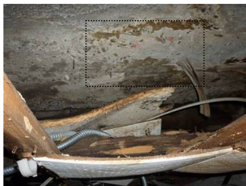
【照片 3-1-152】西翼 13.14 區混凝土樓板磚碎片骨材(98.10.10)
