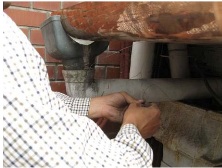
【照片 5-6-139】塑膠落水管以鐵絲固定於天花板(98. 12. 22)
