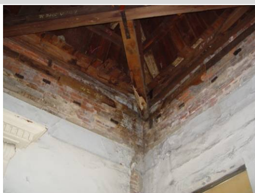
【照片 3-2-24】西翼 201 室塔樓屋頂轉折處水漬(98.07.01)
