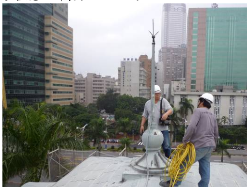
【照片 3-2-46】西翼塔樓前側避雷針 (98. 12. 31)
