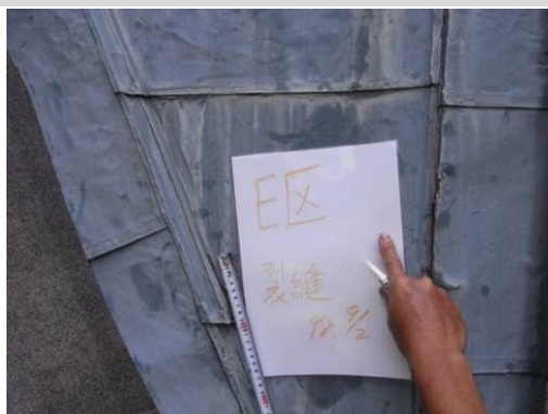
【照片 3-2-30】西翼 18、19 區老虎窗右側銅板裂縫(98.09.02)
