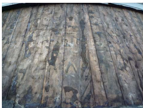
【照片 5-4-25】屋面板修補前情況 (98.11.02)
