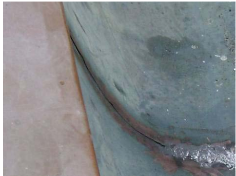
【照片 5-6-371】不鏽鋼天溝搭接處裂縫(98.12.07)
