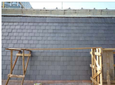
【照片 5-6-147】屋頂木作襯板塌陷 (98.11.25)
