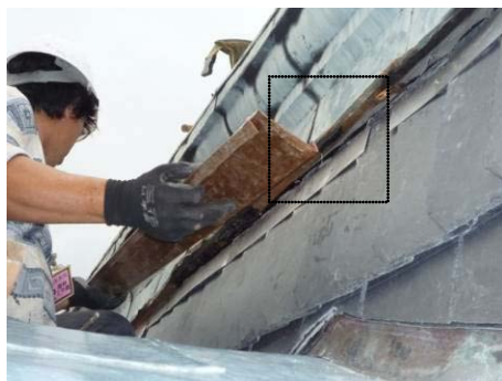
【照片 5-6-171】線板下緣倒鈎與不鏽鋼板相扣 (98.10.14)
