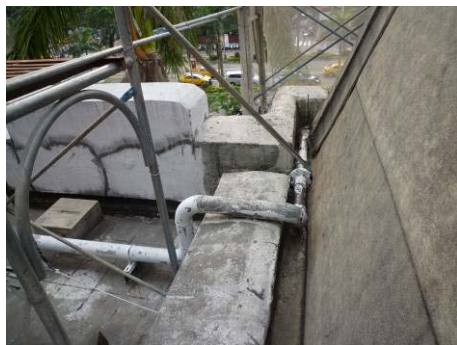
【照片 5-2-27】西翼塔樓前側天溝遷移消防管前(消防管置於天溝內)(98.08.19)
