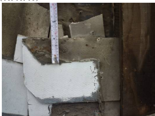
【照片 3-1-89】西翼 1 區斜脊瓦搭接 8.5 公分(98.08.03)
