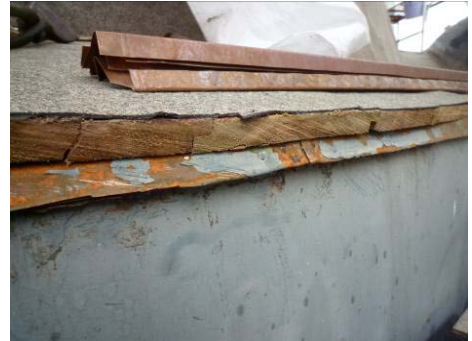
【相片 5-6-336】舊水切板加工向外倒鉤 1.5 公分(98. 11. 24)
