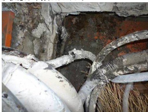
【照片 3-2-44】中央穹頂避雷針導線包覆塑 膠管脆化斷裂(98. 12. 31)
