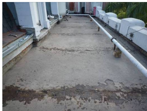
【照片 3-1-156】西翼 1. 2. 3. 4 區平台裂縫 (98. 11. 05)
