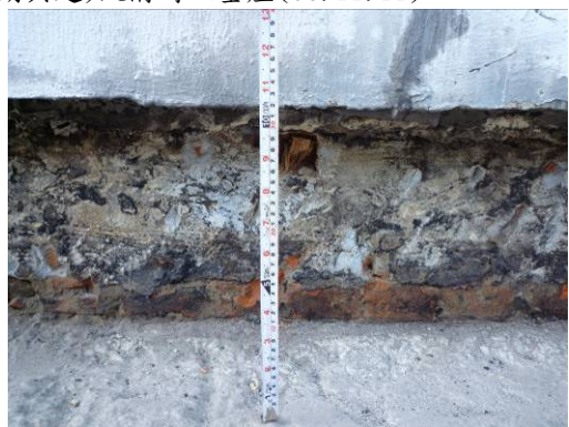
【照片 3-1-189】西翼 4 區平台(第二期興建)女兒牆側木磚距離樓板約 25 公分(98.11.02)
