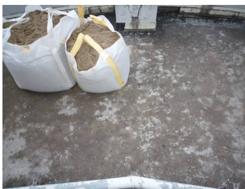
【照片 3-1-182】平台裂縫細部(98.12.20)
