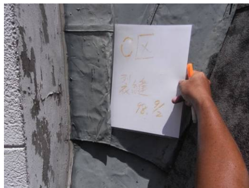
【照片 3-2-34】西翼 9 區老虎窗左側銅板裂縫 (98.09.02)
