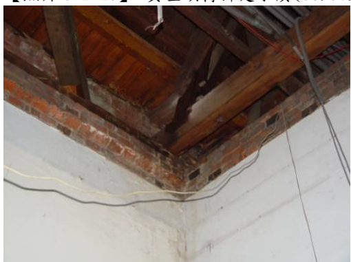
【照片 3-2-27】西翼 202 室牛眼窗周邊漏水(98.07.01)
