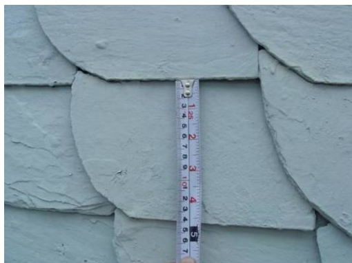
【照片 3-1-97】中央穹頂 3 區之舊石板瓦外露 14 公分(98.06.02)
