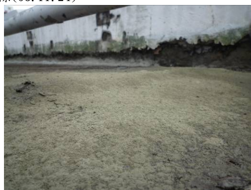
【照片 3-1-168】西翼 4 區平台分期施作之樓板相差約 3 公分(98.11.24)
