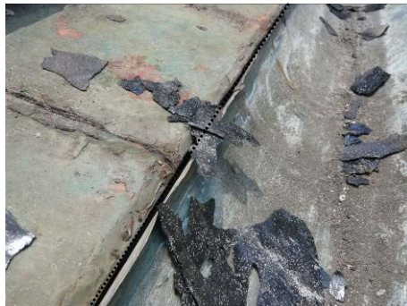
【照片 5-6-51】不鏽鋼天溝原有倒鈎嚴重變形(98.08.18)
