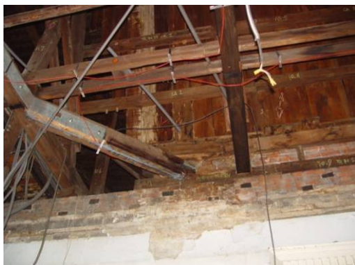
【照片 3-2-25】西翼屋頂轉折處水漬(98.07.01)
