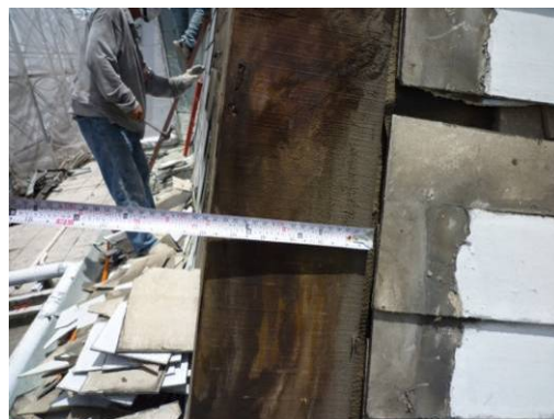
【照片 3-1-88】西翼 1 區斜脊襯材(寬 18 公分、厚 3 公分) (98.08.03)
