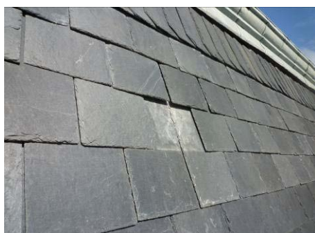
【照片 5-5-142】石板瓦缺角破損(98.11.27)
