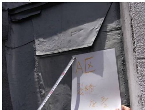
【照片 3-2-38】北翼 1 區老虎窗左側銅板裂縫 (98.09.02)
