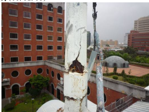
【照片 3-2-50】西翼塔樓後側避雷針嚴重腐朽(98.12.31)
