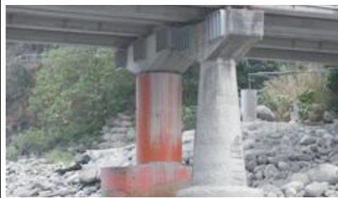
照片 10-12 橋墩鋼筋裸露
