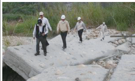
照片 14-13 固床護坦破損
