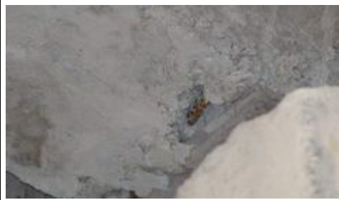
照片 10-10 橋墩鋼筋裸露
