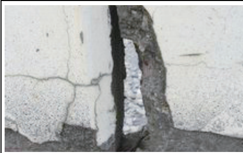
照片 10-5 護欄斷裂
