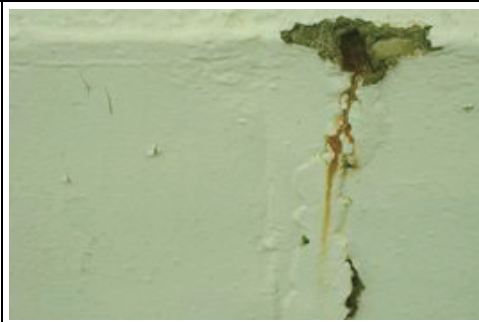
照片 14-10 護欄裂縫破損、鋼筋外露
