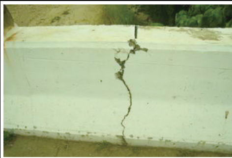
照片 14-9 護欄裂縫破損
