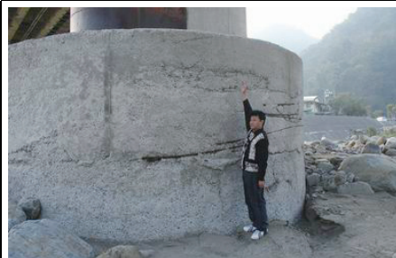
照片 3-7 基礎裸露、鋼筋外露
