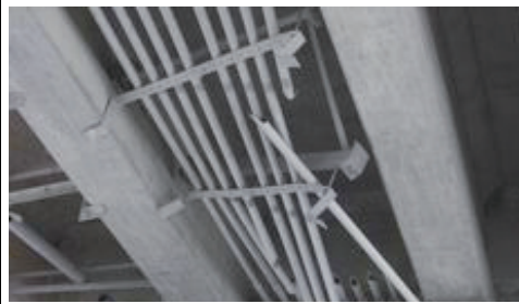
照片 10-8 附掛管線受損
