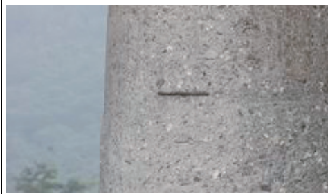
照片 10-11 橋墩鋼筋裸露
