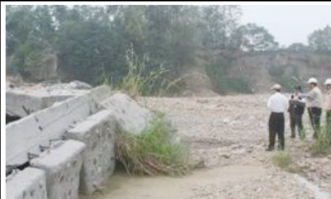
照片 14-15 固床護坦破損
