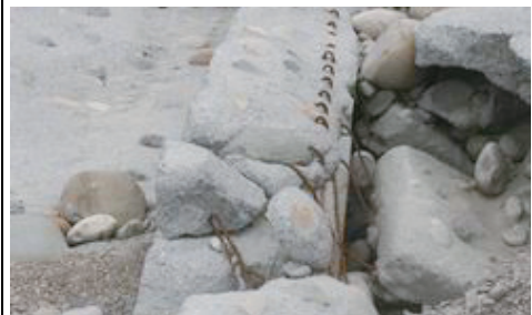
照片 14-14 固床護坦破損
