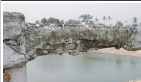
照片 8-5 護欄混凝土劣化、鋼筋裸露
