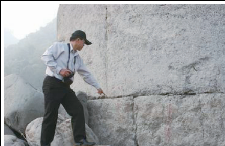
照片 3-8 基礎裸露、鋼筋外露
