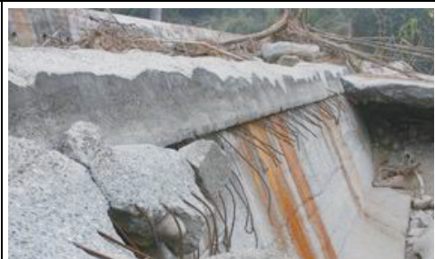
照片 14-16 固床護坦破損
