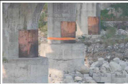
照片 3-6 基礎裸露
