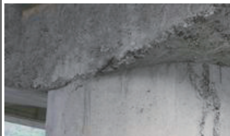
照片照片 10-9 橋墩混凝土蜂巢
