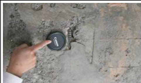
照片 8-8 橋墩混凝土剝落、鋼筋裸露
