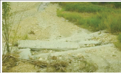
照片 14-11 固床護坦破損
