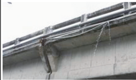
照片 10-7 附掛管線受損
