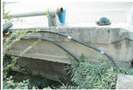
照片 3-3 護欄被附掛管線
