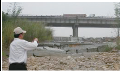
照片 14-12 固床護坦破損
