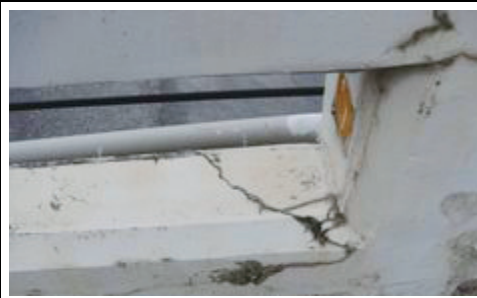
照片 10-6 護欄斷裂
