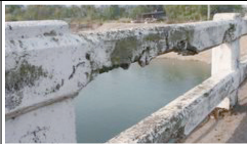
照片 8-6 護欄混凝土劣化、鋼筋裸露
