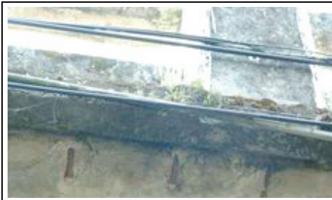
照片 8-1 橋面板混凝土剝落、鋼筋裸露、違法附掛管線
