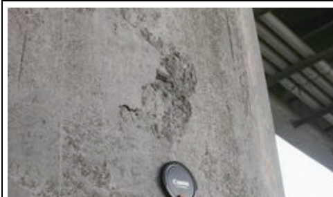
照片 8-7 橋墩混凝土剝落、鋼筋裸露
