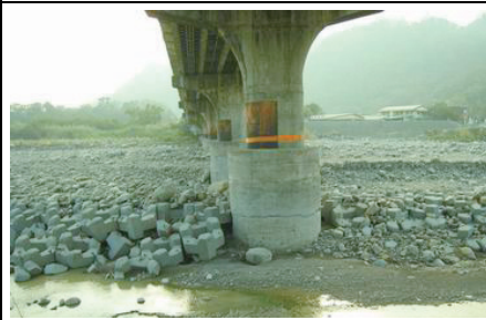
照片 3-5 基礎裸露
