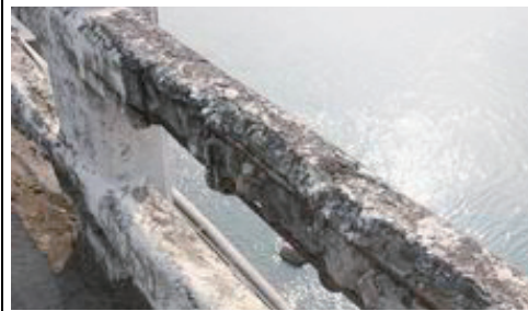
照片 8-4 護欄混凝土劣化、鋼筋裸露
