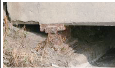
照片 8-3 A2 橋台支承鏽蝕嚴重
