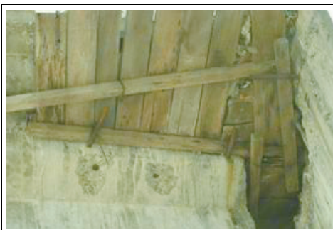
照片 6-1 模板未拆
