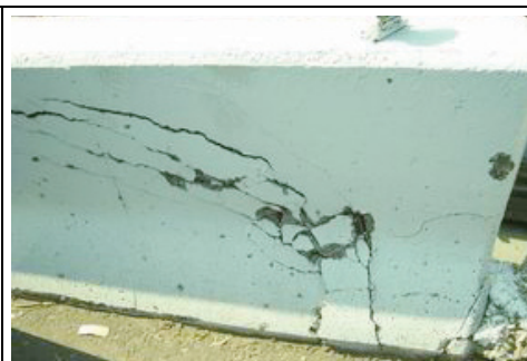
照片 6-2 護欄裂損
