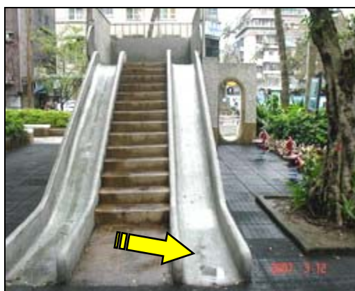
照片 1-5-9 滑梯滑槽底端與地面無高差且積水
