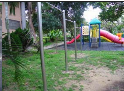
照片 4-2-2 單槓區為泥土草地，未鋪設安全地墊
