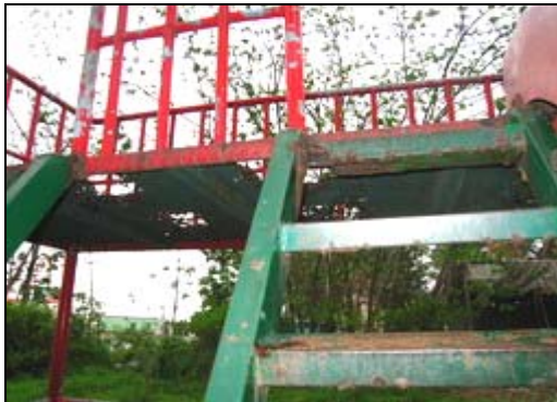
照片 4-2-9 滑梯爬階鏽蝕、平臺板鏽蝕破洞
