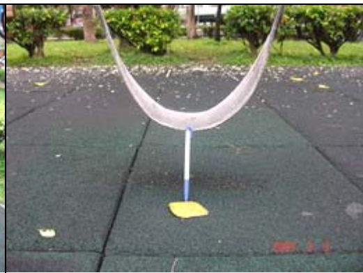
照片 1-6-2 鞦韆座椅離地面過近
