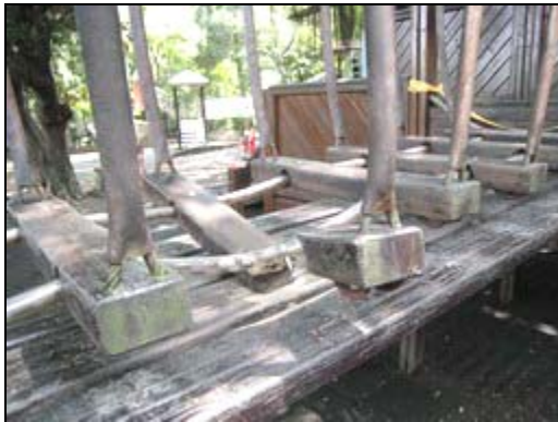
照片 3-1-15 木製綜合遊具水平吊橋橫桿斷裂
