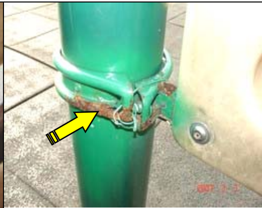
照片 1-7-5 綜合遊具平臺護欄連接點鏽蝕
