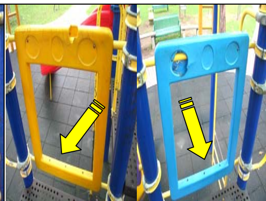
照片 4-2-6 綜合遊具平臺護欄桿件已脫落，計缺 6 根
