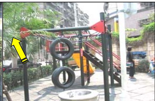
照片 2-5-10 遊樂設施與周邊設施安全緩衝空間不足
