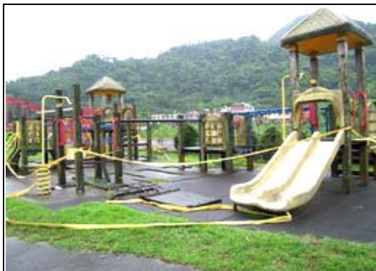
照片 2-17-1 綜合遊具損壞，未封閉妥善
