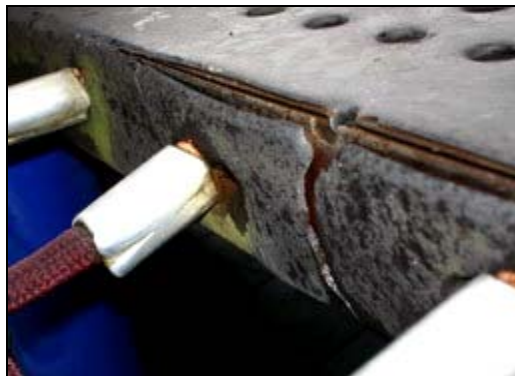
照片3-12-3 綜合遊具平臺鏽蝕
