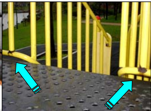
照片3-12-4 綜合遊具欄杆鏽蝕
