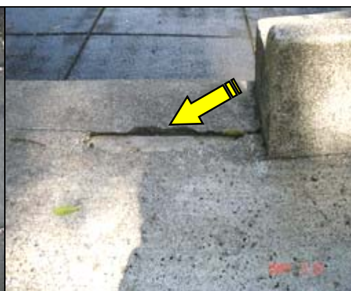
照片 1-11-4 滑梯滑槽底端水泥表面剝落
