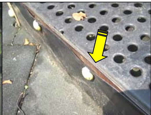
照片 2-2-2 綜合遊具踏階面層剝離
