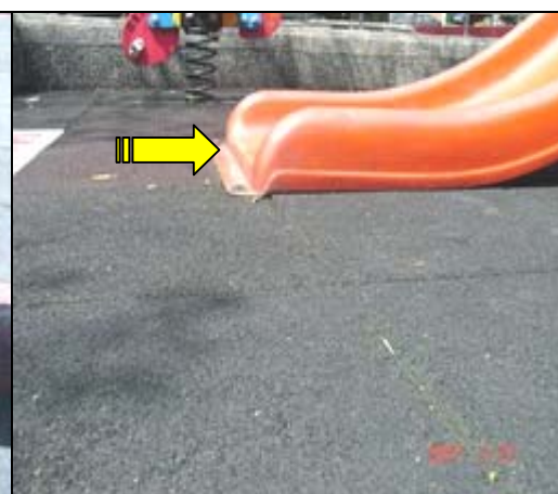
照片 1-12-6 綜合遊具滑梯滑槽底端高差不足
