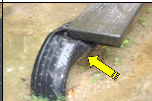
照片 3-11-8 翹翹板緩衝輪胎破損
