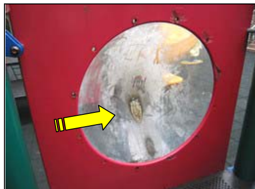
照片 3-1-1 綜合遊具平臺壓克力護欄有燒灼痕跡
