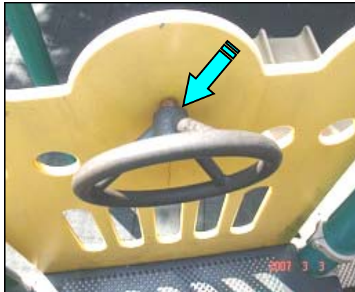
照片 1-10-6 綜合遊具平臺上方向盤鬆脫下垂
