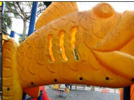
照片 1-9-5 綜合遊具表面髒污
