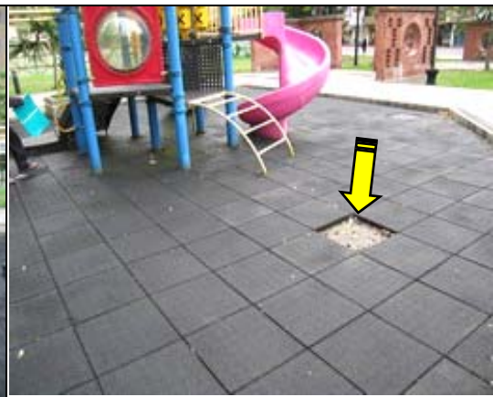
照片 2-1-9 安全地墊缺漏一塊
