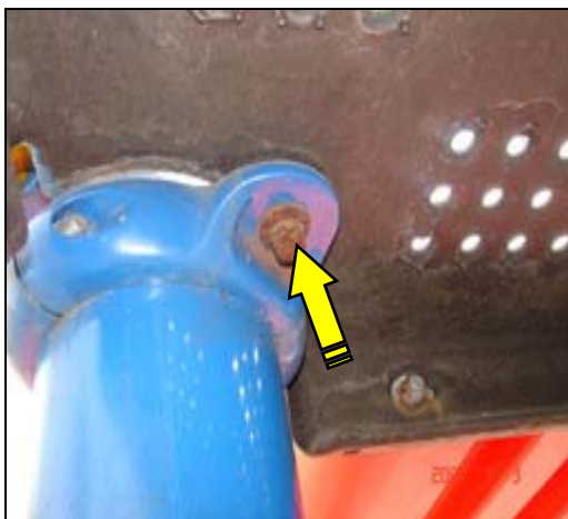
照片 1-7-6 綜合遊具螺絲鏽蝕
