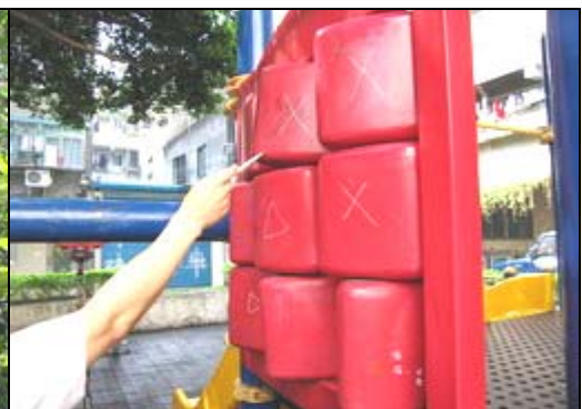
照片 2-2-14 綜合遊具平臺護欄元件鬆脫歪斜
