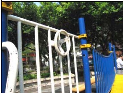
照片 2-2-15 綜合遊具平臺上方向盤鬆弛
