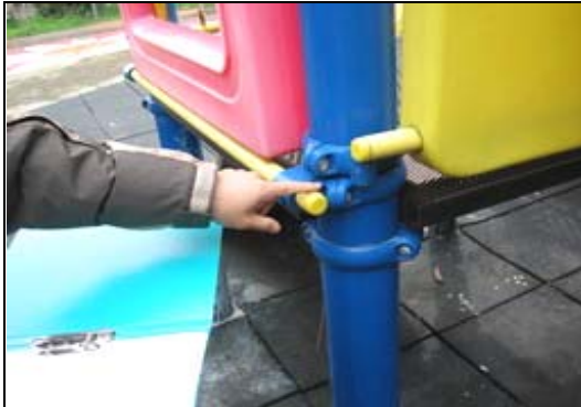
照片 4-1-5 綜合遊具平臺護欄接點鬆脫
