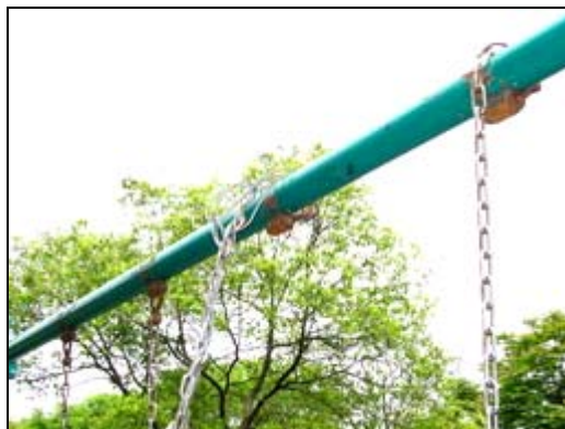
照片 2-14-1 鞦韆鏈條脫落
