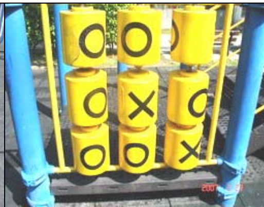
照片 1-4-2 綜合遊具護欄元件破損
