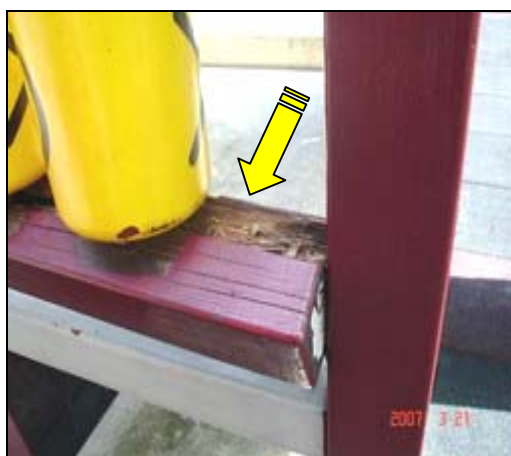
照片 1-12-5 綜合遊具平臺護欄橫桿腐蝕鬆脫
