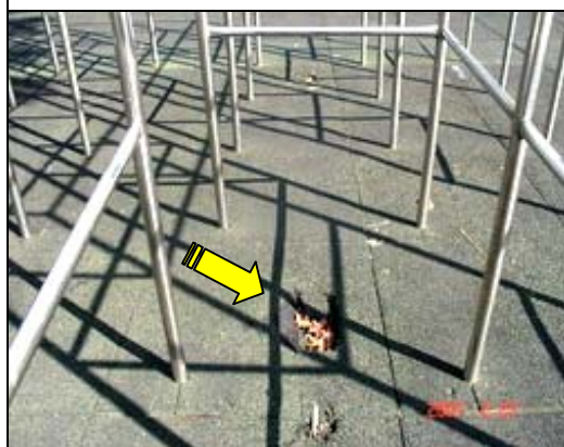
照片 1-1-3 攀爬架下安全地墊破損
