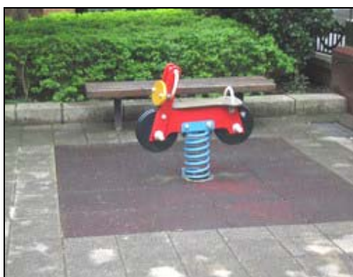
照片 3-2-1 搖搖馬與座椅間之安全緩衝距離不足
