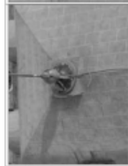
圖片2-46 現況說明：屋頂鋼板計畫因有剝離老化，予以換裝。 修復說明： 1. 鋼板計畫因有剝離老化，進行拆除，
