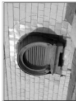
照片 1-17 照片說明：牛欄崗道樓台瓦頂屋頂屋身小洞，牛欄崗道屋頂屋身小洞，牛欄崗道屋頂屋身小洞。 修復說明： 1. 於屋身小洞處進行補瓦處理，防止雨水滲透。 2. 牛欄崗道屋身小洞處，屋頂台瓦瓦片處，進行補瓦處理。
