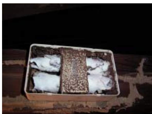
11. 回測檢視，北側衛塔白蟻活動頻繁 (2006-04-13，驗收前回測檢視)
