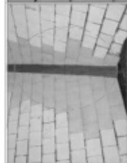
圖片2-18 現況說明：石頂瓦屋瓦排布有構施工不良，予以修補。 修復說明： 1. 對原有瓦屋瓦排布予以修補，防止滲透。 2. 對原有瓦屋瓦排布予以修補及修補。
