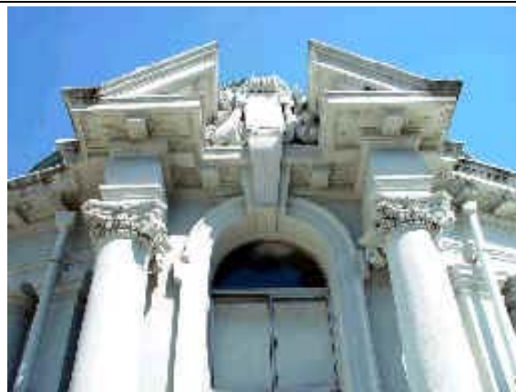
圖版 2-15.破縫山牆細部現況
