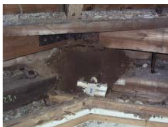
12. 回測檢視，北側衛塔白蟻活動頻繁 (2006-04-13，驗收前回測檢視)
