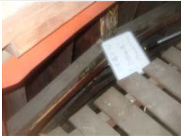
【圖版 5-41】木構件調查作業 參區，D 架構件 7R（天下營造提供）
