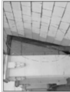
照片1-09 現況說明：配合原樓層立樑及鋼架桁架中樑，重新安裝吊頂式吸音磚。 修復說明： 1. 拆除原有吸音磚及吊頂式吸音磚，防止霉變。 2. 重新安裝吸音磚及吊頂式吸音磚，保證吊頂式吸音磚。
