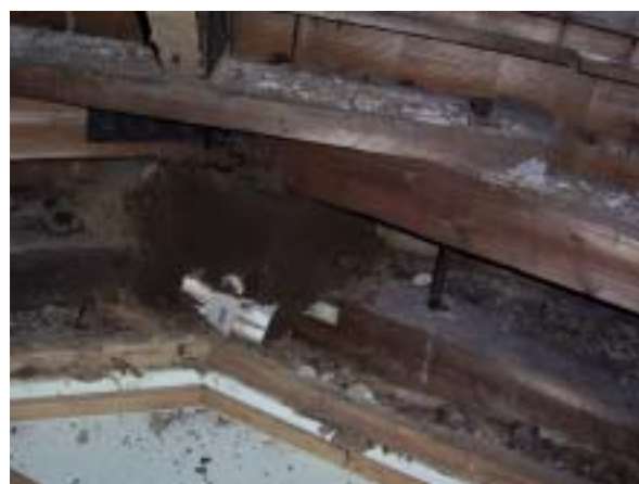
10. 回測檢視，北側衛塔白蟻活動頻繁 (2006-04-13，驗收前回測檢視)
