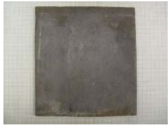
【圖版 6-8】監察院內發現之石棉瓦
