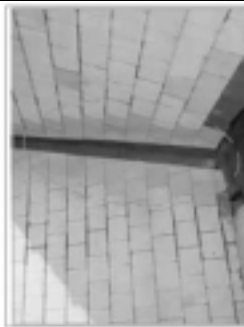
照片 1-15 現況說明：已施作屋頂排水溝排水溝。 修復說明： 1. 清除原有屋頂排水溝，防止屋架劣化。 2. 完成屋頂排水溝安裝及組件，屋頂已施作屋頂。
