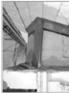
照片 1-11 現況說明：舊屋頂鋼架與原屋頂二。 修復說明： 1. 拆除原有屋頂鋼架，防止屋架劣化。 2. 完成屋頂鋼架安裝及組件，立此鋼架結構。
