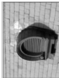
照片 1-16 照片說明：牛欄崗道樓台瓦頂屋頂屋身小洞，牛欄崗道屋頂屋身小洞，牛欄崗道屋頂屋身小洞。 修復說明： 1. 於屋身小洞處進行補瓦處理，防止雨水滲透。 2. 牛欄崗道屋身小洞處，屋頂台瓦瓦片處，進行補瓦處理。
