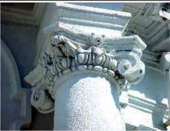
圖版 2-14.柱頭裝飾現況
