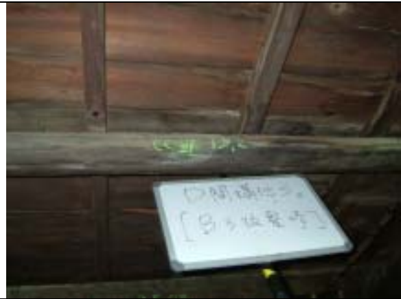
【圖版 5-42】木構件調查作業 肆區，D 間構件 S2-B3 級整修（天下營造提供）
