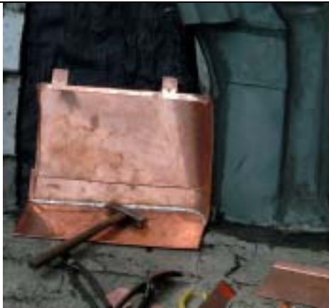
【圖版 5-153】搭接(一片)完成並加釘固定料 (釘材需在之後被覆蓋不得外露)
